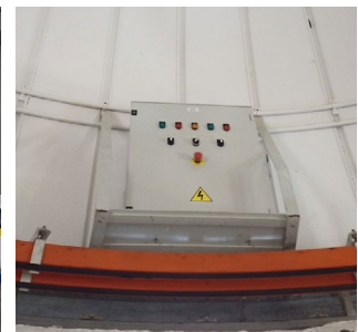
Fig. 2 Nuevo controlador "Esclavo".
