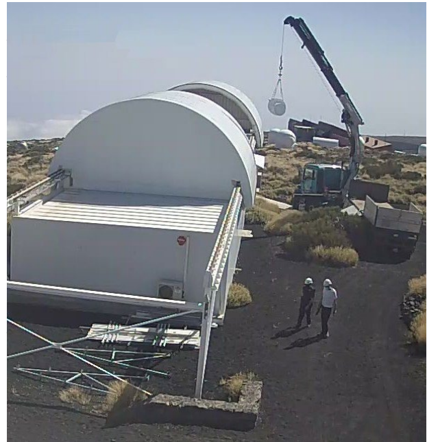
Instalación del Instrumento FTGI en el QT2.
